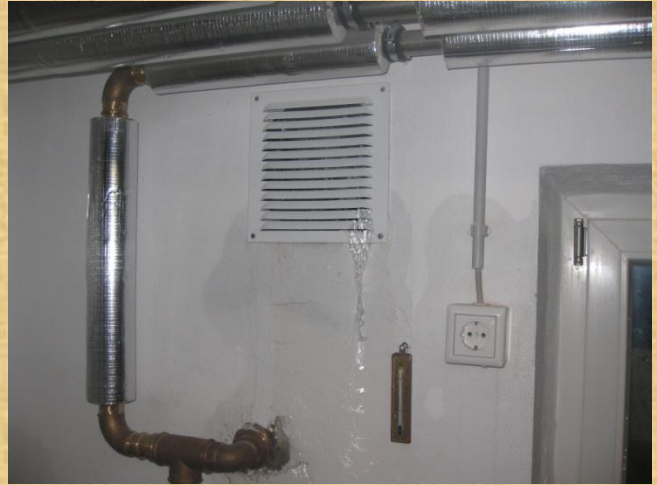
Wasser strömt durch einen Lüftungsschacht in den Keller ein.
